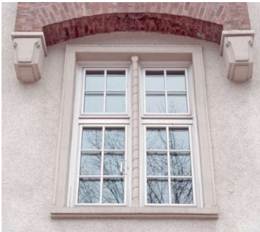
Abb. 39 Rostock, Lange Straße, Block D Nord, Fenster, Straßenzug errichtet 1953-1958, Chefarchi- tekt Joachim Näther, verantwortliche Archi- tekten Block D Nord: Näther und Ernst Eick, Aufnahme 2001.
